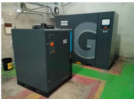
บูรณาระบบต้นกำเนิดลมอัด เปลี่ยนปั๊มลมใหม่ 75 กิโลวัตต์
