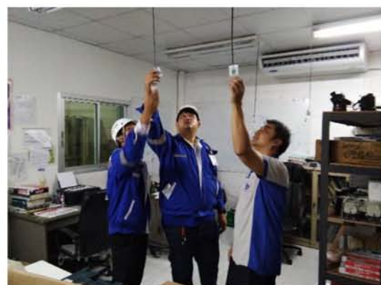
แยกสวิตช์ ปิด-เปิด ระบบไฟแสงสว่างในสำนักงาน
